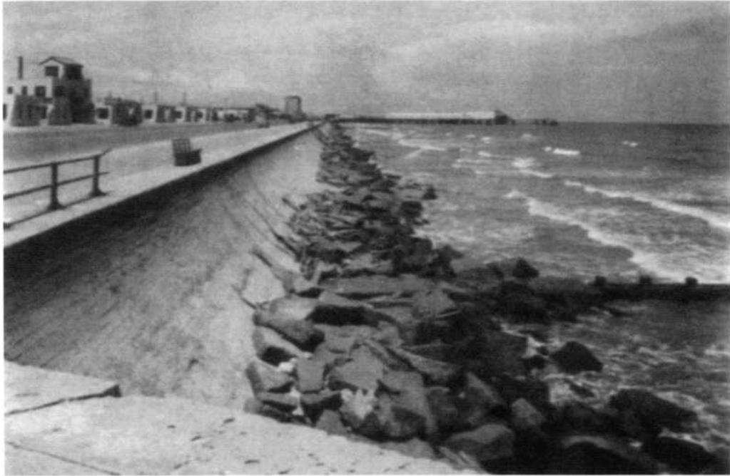
原加尔维斯顿海堤的一部分，于1904年完工。注意墙的凹面，旨在破坏风暴驱动的海浪；以及锚定结构底部的碎石堆。
